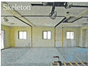
鉄筋マンションだから間仕切り壁は人力で慎重に解体
